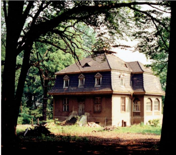
Abb. 6: Zustand der ersten Villa am Oberweg im Jahre 1990, kurz vor ihrer Sanierung (Hans Schmidt, Bad Muskau).
